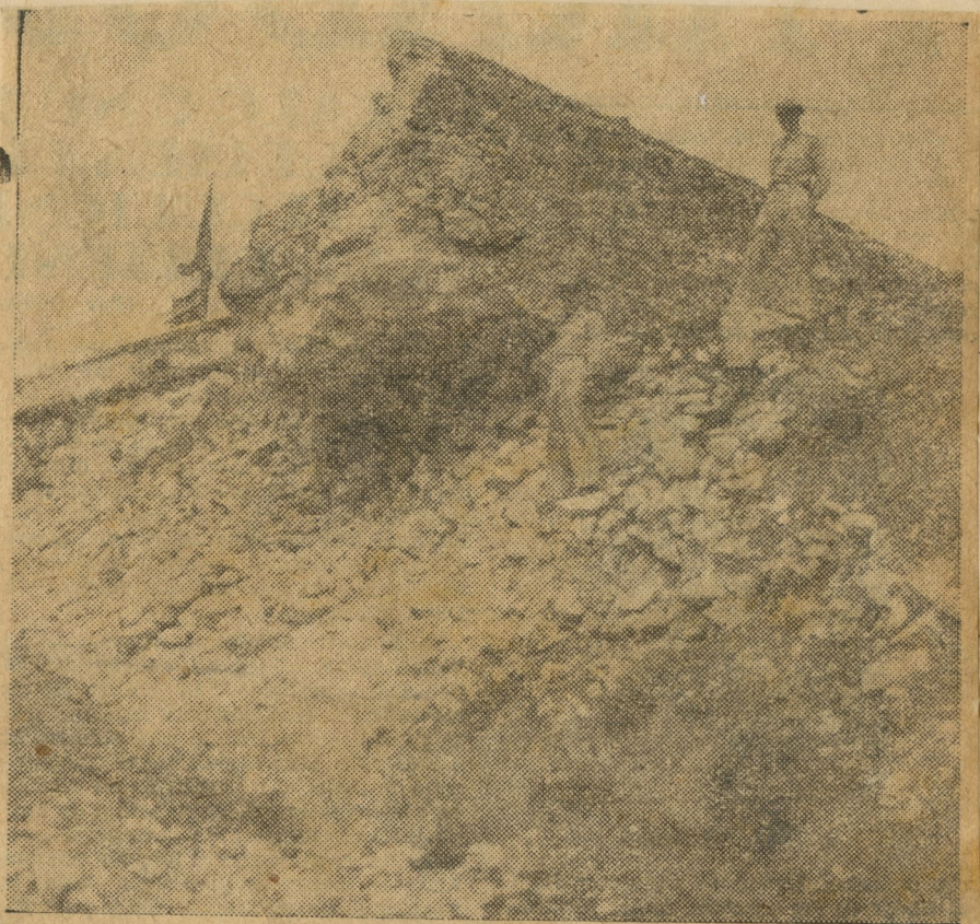
Dos soldados señalan los lugares donde más han sufrido los bastiones del viejo castillo de Atarés, desmoronados por la acción —inexplicable— de las piquetas de Obras Públicas, que ahora están luchando para reparar el daño causado a los cimientos de la fortaleza con las extracciones de arcillas de sus faldas y fosos.
