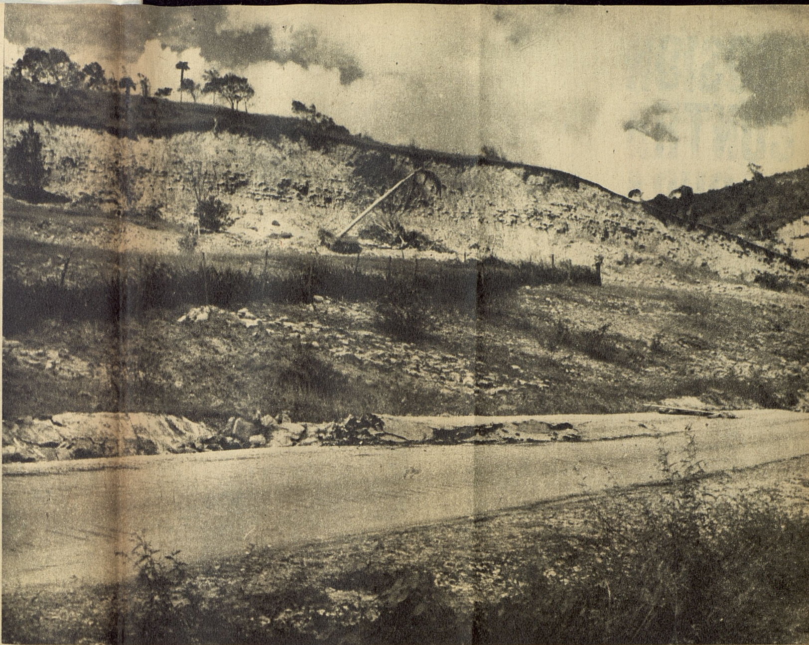
LAS ALTURAS DE REJONONES DE BAGUANOS, DESDE HACE MUCHOS AÑOS SE DESLIZAN PRODUCIENDO DAÑOS A LOS TERRENOS. LA LOMA CORTADA POR EL DESLIZAMIENTO PRESIONA SOBRE LA CARRETERA Y LA DESTRUYE CONSTANTEMENTE DESDE HACE VARIOS LUSTROS.
