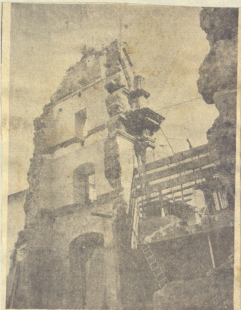
La piqueta demoledora de lo antiguo para dar paso al progreso, puede apreciarse en toda su importancia, en esta fotografía, donde aparecen paredes, nichos, capitales, etc., del Convento de Santo Domingo. Un gran proyecto para el Banco Nacional de Cuba, que ocupará la manzana donde en 1578 se levantó el viejo Convento.
