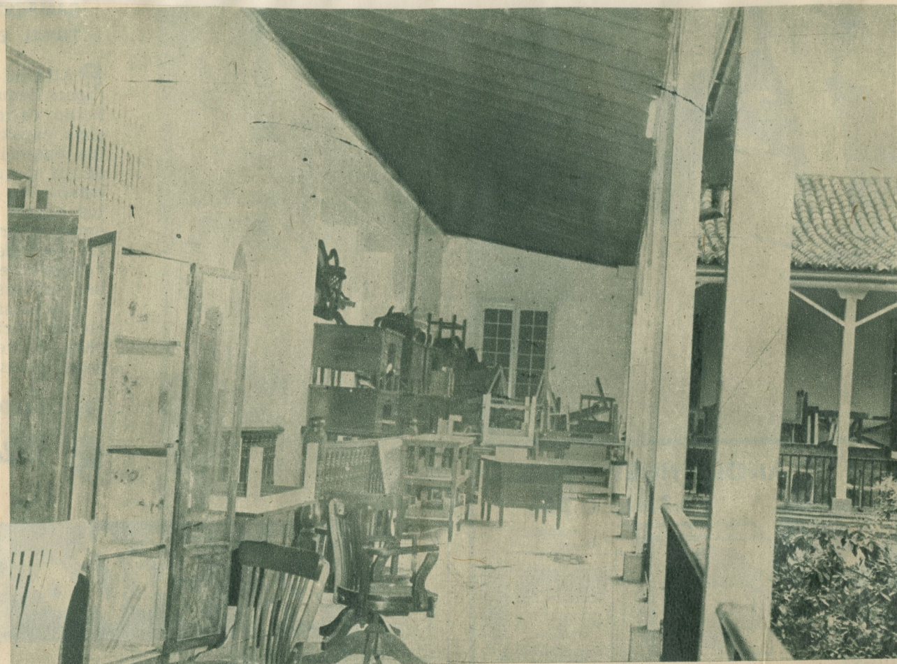
... día tras día muebles y escaparates han permanecido colocados sobre las débiles galerías de tres siglos de fabricadas, con grave peligro de derrumbe.
