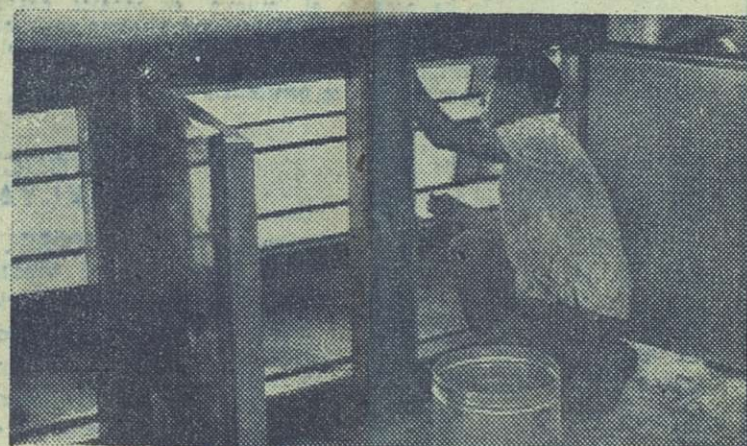
La Brigada de Varadero también contaba con un técnico de refrigeración.
