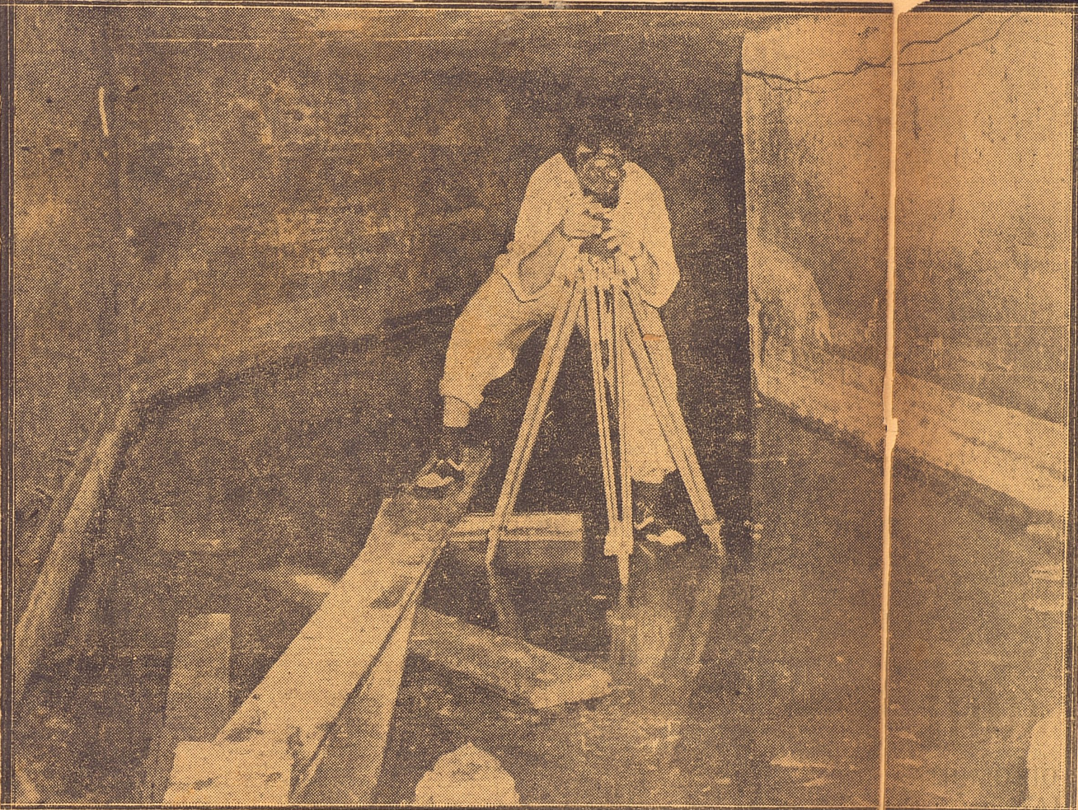
Debajo de la Plaza de Agua Dulce y Rancho Boyeros corren las aguas de la Zanja Real. Vemos aquí el interior del túnel por donde el pestilente líquido se halla encauzado. Un "cameraman" toma vistas del mismo.
