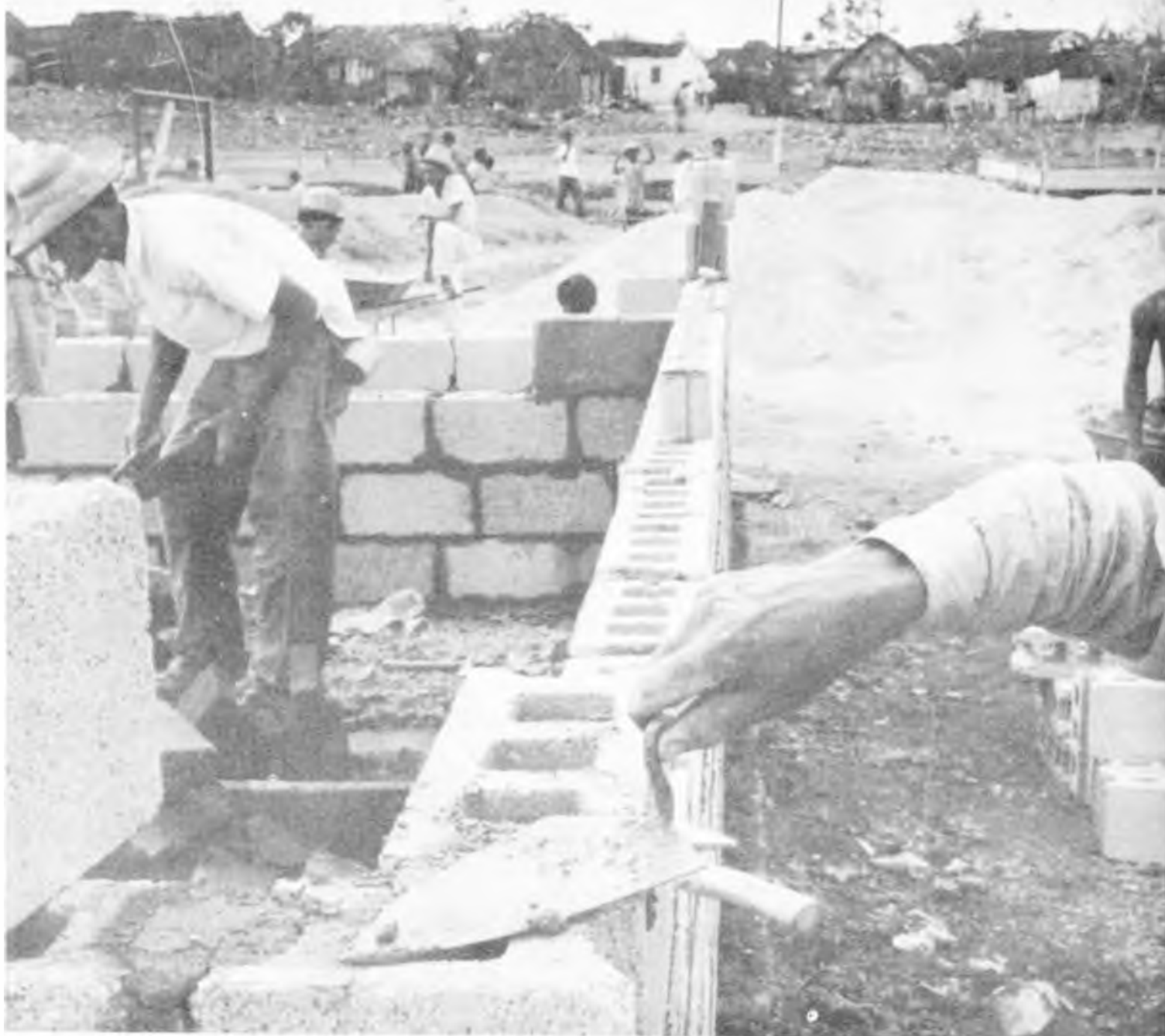
Los bloques comienzan a apilarse. Las paredes se levantan. Las casas surgen y van desplazando a los bohíos insalubres, de techo de guano y piso de tierra, donde han malvivido hasta el presente los moradores de "La Chirusa".
