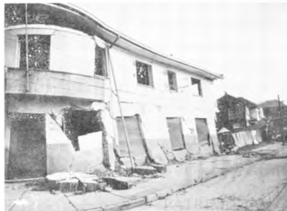
Otras viviendas quedaron medio destruídas.
