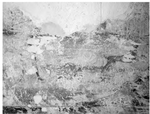
Decoración más antigua y estado de conservación antes de nuestra intervención
