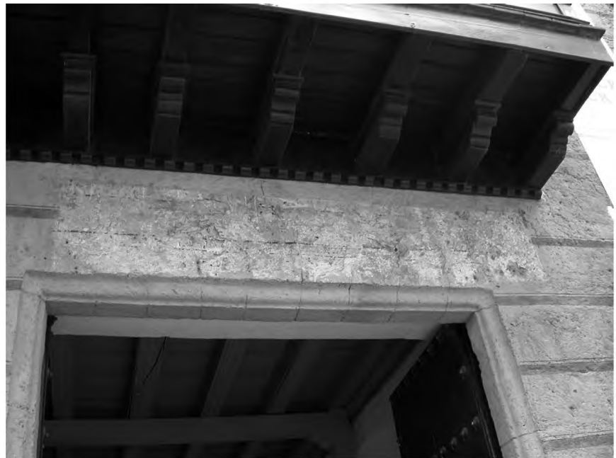
Fig. 4. Obispo 117-119. Fachada que muestra dos diseños lineales: ocre y negro, que ornamenta todo el frente y un vestigio arqueológico de colores azul y negro sobre fondo blanco.
