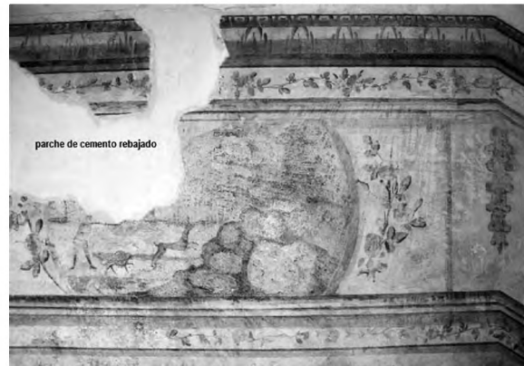
Izquierda. Después de la restauración y muestra de uno de los parches de cemento rebajado
