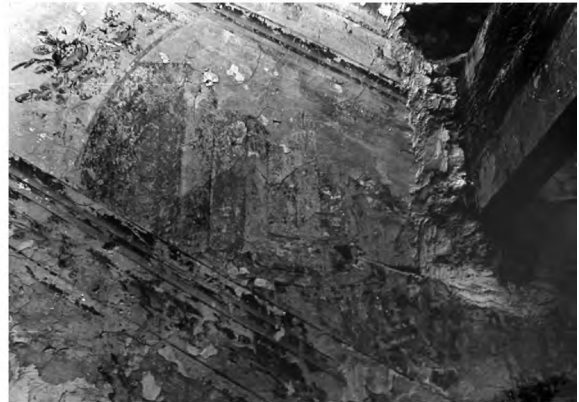
Estado de la decoración más antigua durante la primera intervención en 1996
